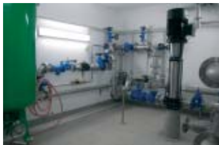
Mit Schütz-Technik ausgerüstete Wasserversorgungsanlage.
