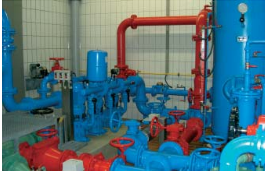
Blick in das „Innenleben“ des Hochbehälters Altheim.
